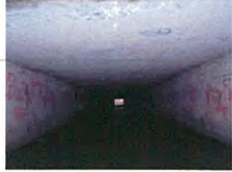
07 - Typ S end culvert condition.jpg
